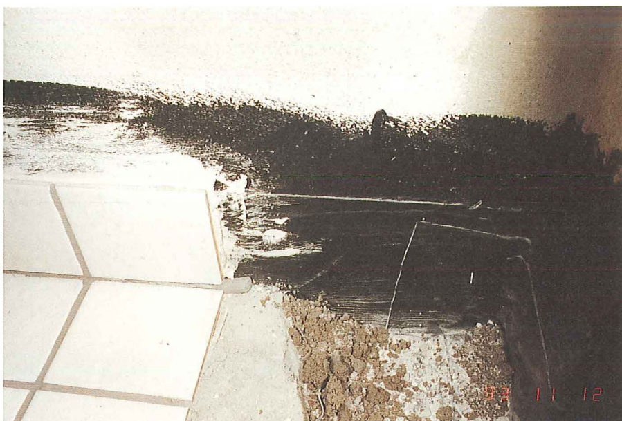
Foto 5. Indvendig hjørne og overgang guly/væg. Der er foretaget armering og udlagt afretningslag. Bagstop placeret mellem gulvclinke og sokkelflise.
